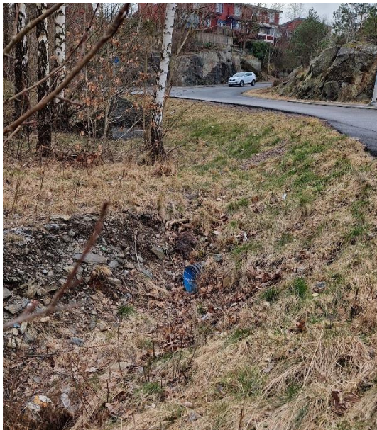
Figur 14. Bräddutlopp från allmänt dagvattenledningsnät i Gårdstensvägen till dike (Foto: Kretslopp och Vatten).
